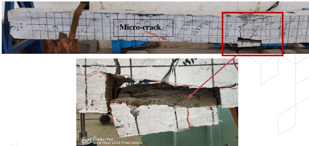
b. Kegagalan delaminasi pada BGP
