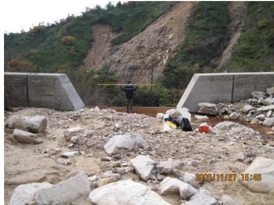
Gambar 1. Endapan sedimen di sebelah hulu cek dam tertutup.
