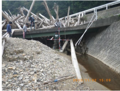
Gambar 2 Penumpukan aliran debris kayu pada jembatan yang berada di Sungai Nayoshi (Tsuwano, 2013)
